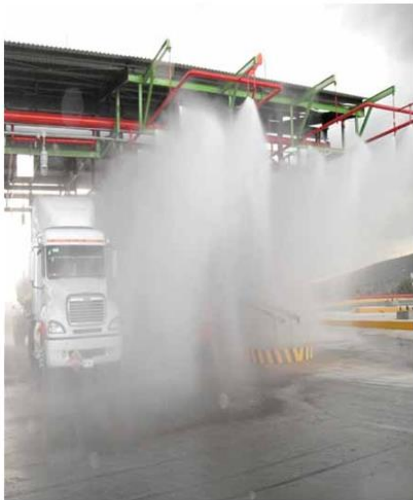
Figura 9. Zona de carga de autotanques.
